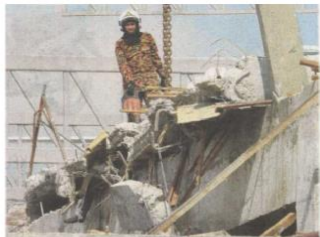
ANGGOTA bomba melakukan kerja-kerja menyelamat ekoran kejadian tempat letak kereta runtuh di sebuah pasar raya di Pulau Sebang, Melaka pada Jun lalu. – Gambar hiasan.
